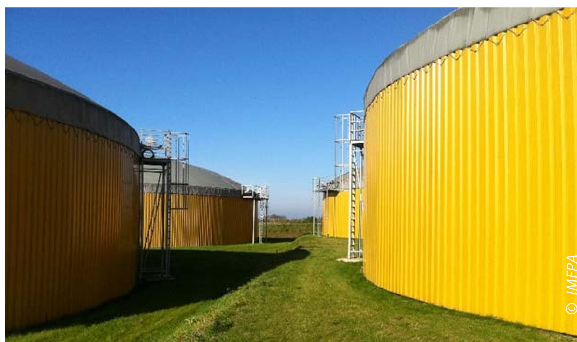
Abb. 1: Gärbehälter einer Biogasanlage
