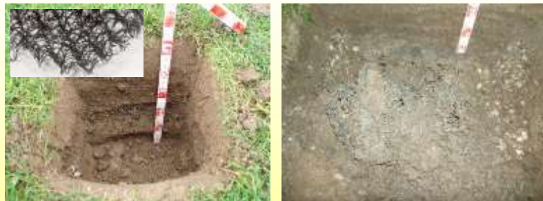
Enkamat 30 Jahre nach Einbau in 14 cm Tiefe
